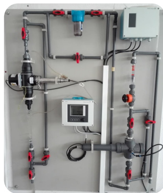
Panely měření UV absorbance
